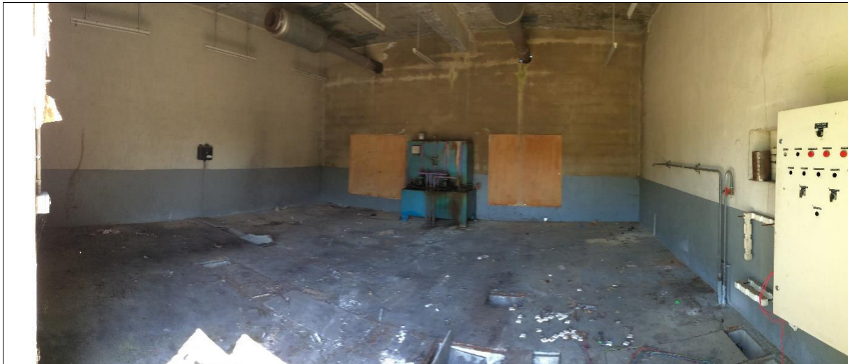
Vue du local du groupe électrogène GE4
