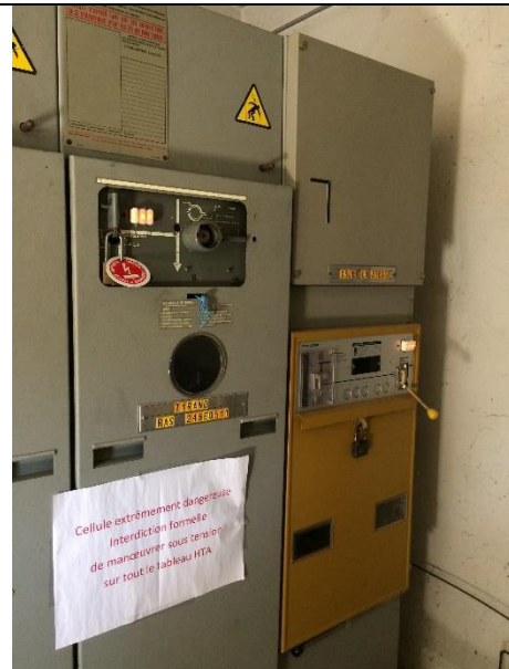
Vue du transformateur P4 en tension
