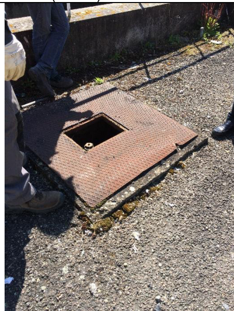
Vue de la cuve enterrée n°14 a dans la cour du site
